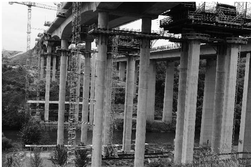
Neu neben alt: Die neue Lahntalbrücke befindet sich noch im Bau. Ende des Jahres soll hier aber schon der Verkehr rollen. Die alte Brücke wird im kommenden Jahr abgerissen.
