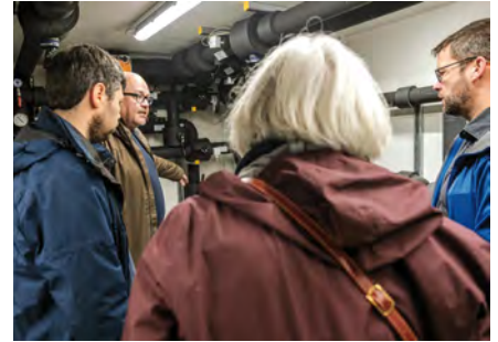
Aufgrund der beengten Räumlichkeiten in dem früheren Luftschutzbunker benötigte das geothermal gekühlte Rechenzentrum der Stadt Fulda speziell gefertigte Bauteile.
